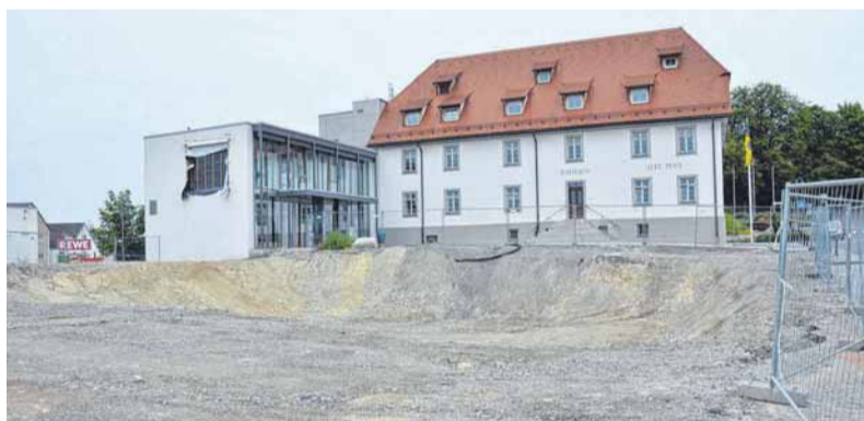
Die Baugrube ist bereit. Der Gemeinderat muss noch die erforderlichen Beschlüsse für den Bürgersaal fassen.
